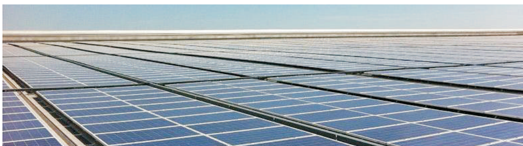
山东玉昊隆集团屋顶光伏电站 装机容量：3MW
