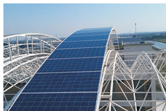
BIPV组件集成到 建筑上的发电系统
