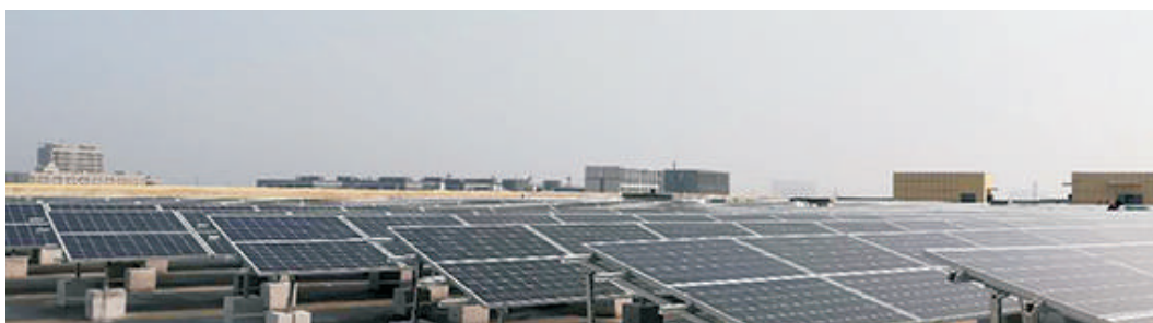
人民（武汉）国际汽车城屋顶光伏电站 装机容量：2MW
