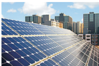
BAPV建筑 屋顶上安装的发电系统
